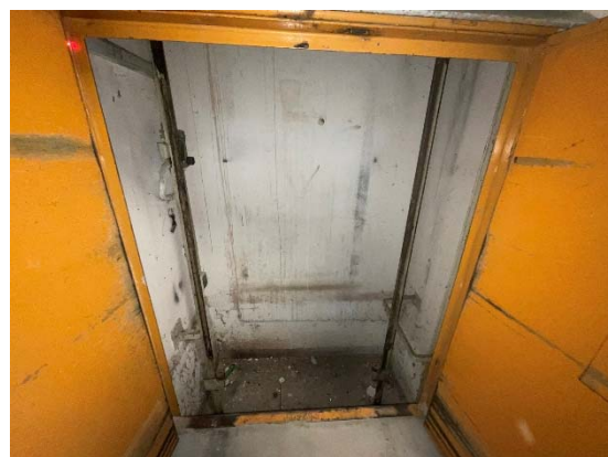
Foto Schachttür Kleinlastenaufzug
