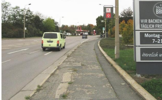
Foto: Gehwegschäden Ostseite S 172
