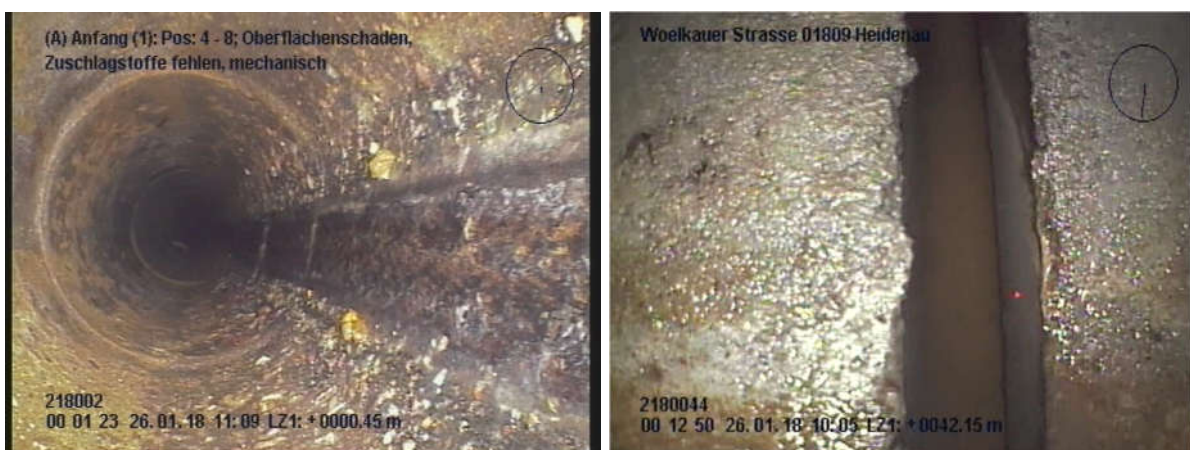
Abbildung 70: Schadensbilder im MWK „Wölkauer Straße“
