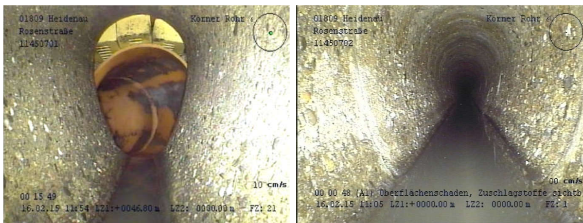
Abbildung 61: Schadensbilder MWK „Rosenstraße“
