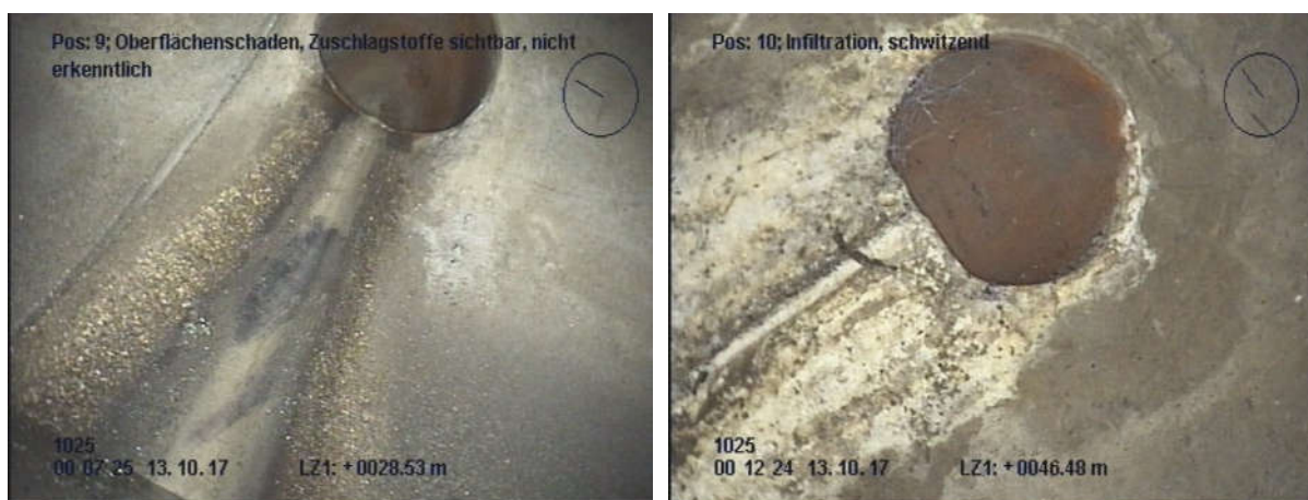
Abbildung 51: Schadensbilder MWK Nordstraße
