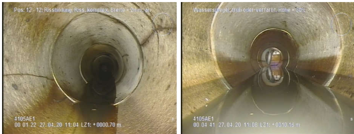
Abbildung 9: Schadensbilder MWK „Diesterwegstraße“
