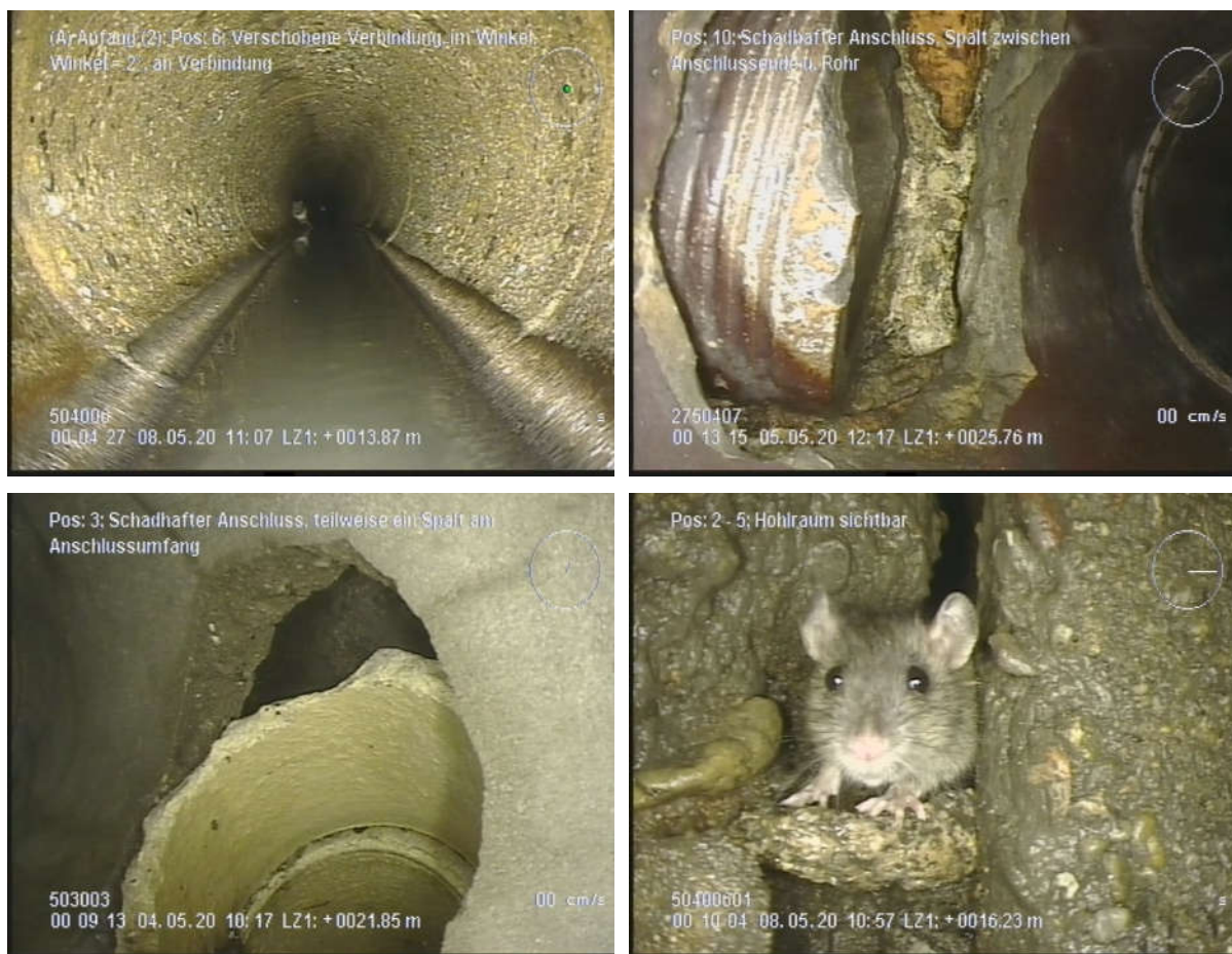
Abbildung 43: Schadensbilder MWK „Martin-Luther-Straße“
