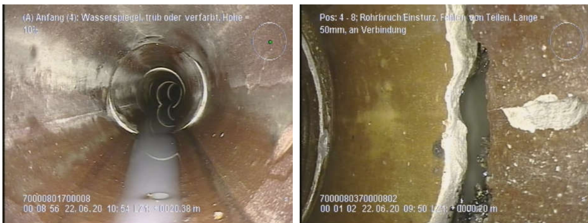
Abbildung 37: Schadensbilder MWK „Karl-Liebknecht-Platz“
