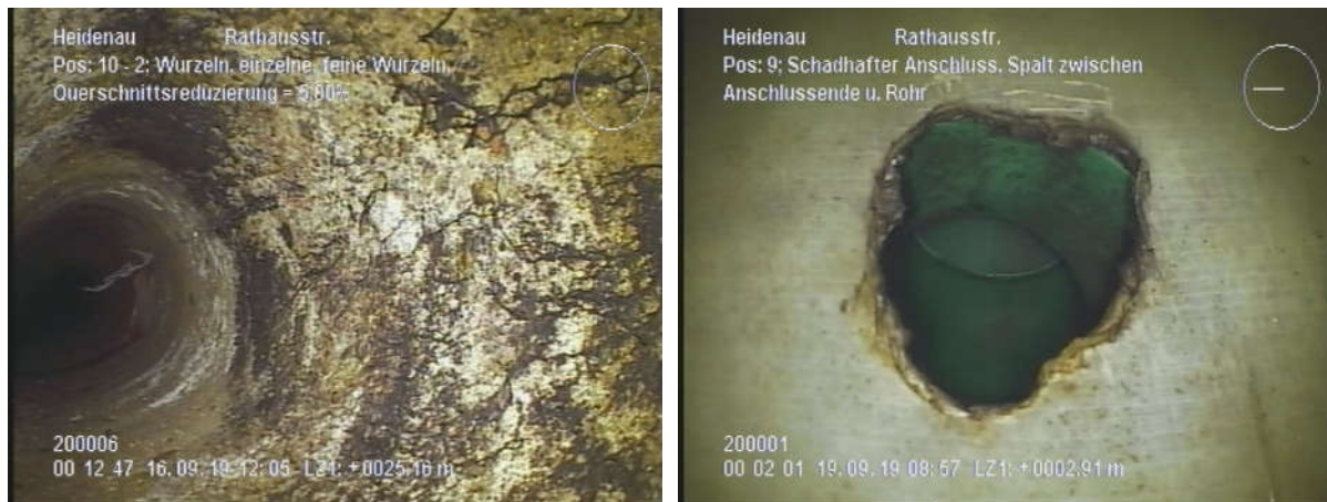
Abbildung 55: Schadensbilder MWK „Rathausstraße“
