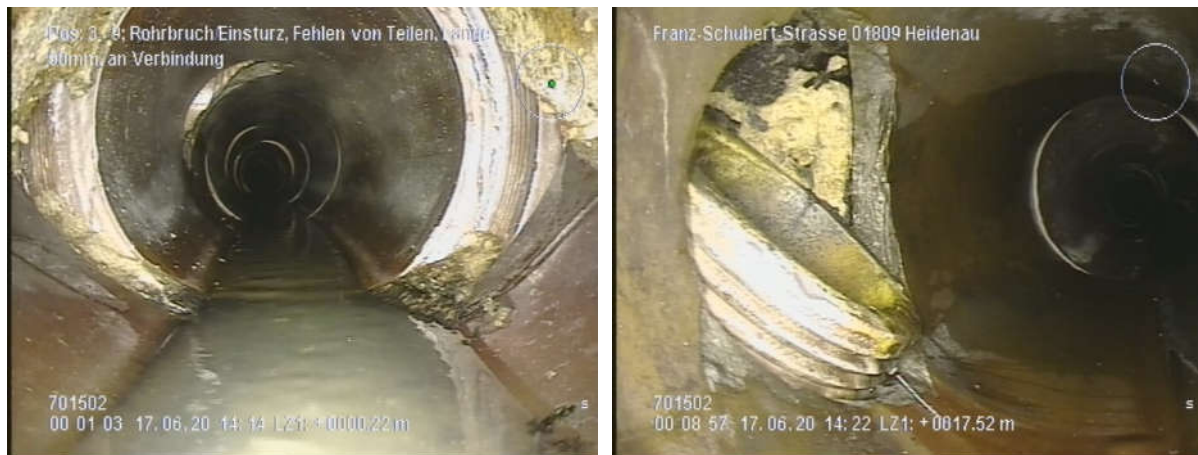
Abbildung 20: Schadensbilder MWK „Franz-Schubert-Straße“
