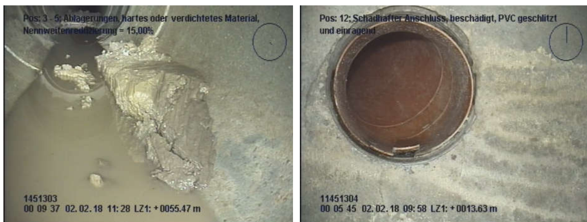
Abbildung 45: Schadensbilder MWK „Meuschaer Weg“
