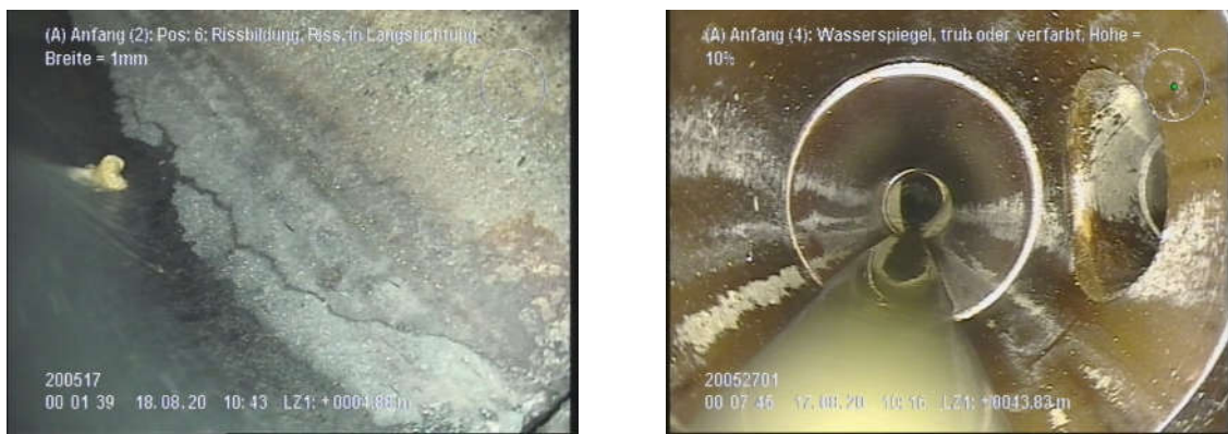
Abbildung 18: Schadensbilder MWK „Emil-Schemmel-Straße“
