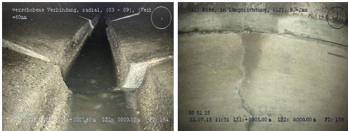
Abbildung 63: Schadensbilder MWK „Rudolf-Breitscheid-Straße“ (Sonderprofil mit Trockenwetterrinne DN 1400 B)
