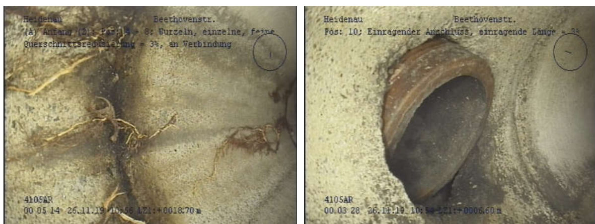
Abbildung 7: Schadensbilder MWK „Beethovenstraße“ westlich vom Böhmischer Weg
