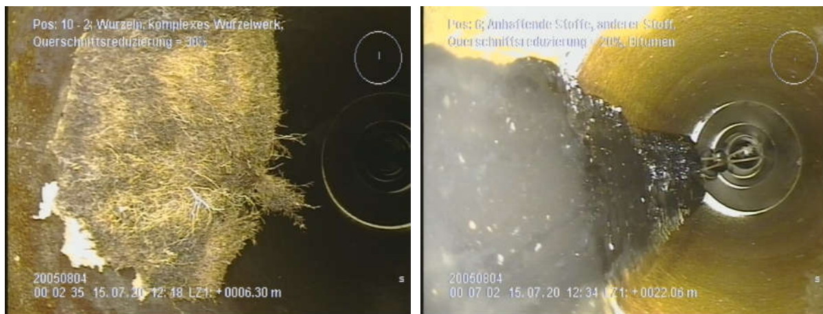
Abbildung 11: Schadensbilder MWK „Dr.-Otto-Nuschke-Straße“
