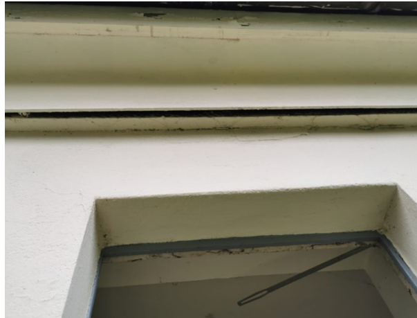
Abbildung 18: Spalt an Fassade
