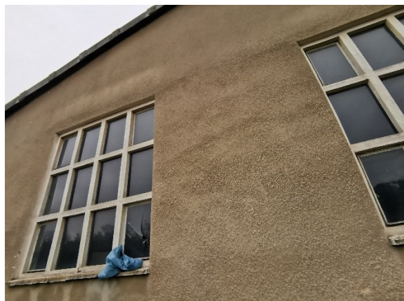
Abbildung 38: Lagerhalle; ausgeschäumtes Fenster
