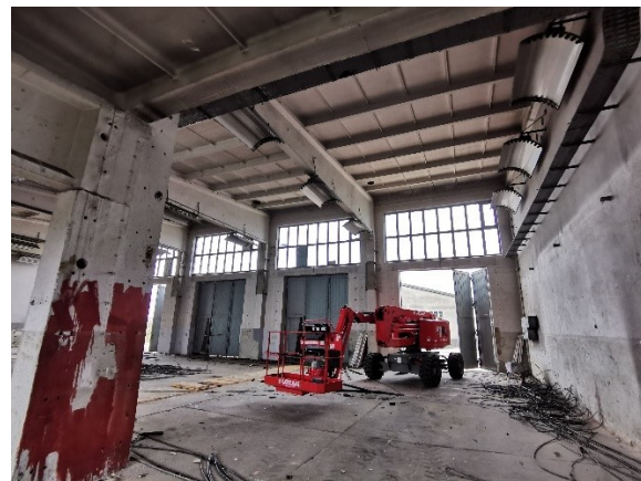
Abbildung 32: Werkstatt; Innenbereich und Hubsteiger
