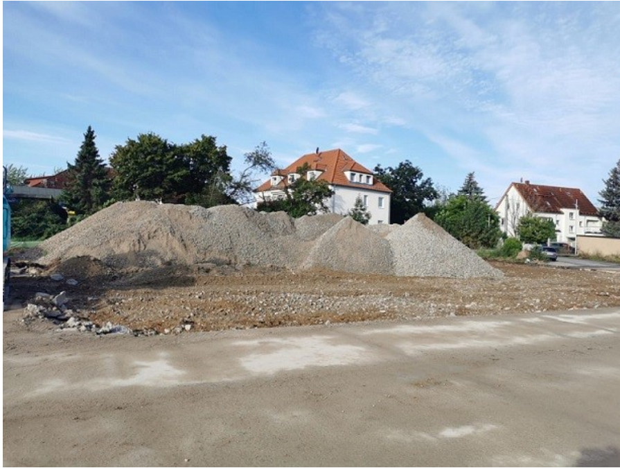
Abbildung 19: Schutthaufen auf dem Gelände
