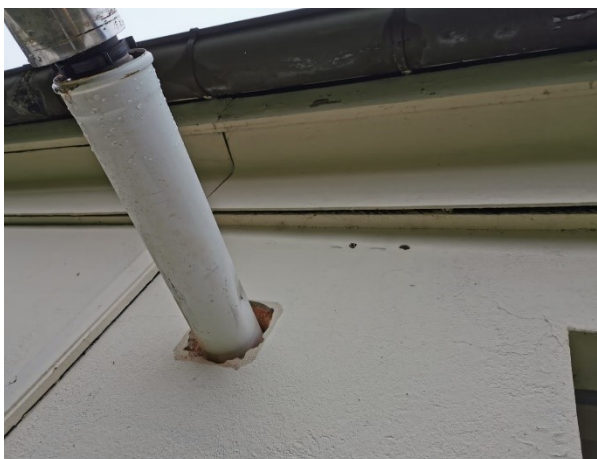
Abbildung 17: Spalt an Fassade
