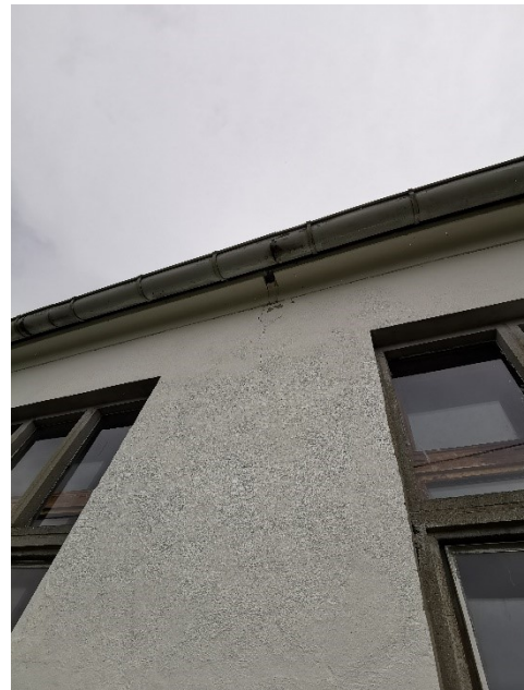
Abbildung 28: Werkstatt; Nahaufnahme des Spaltes am Dachüberstand
