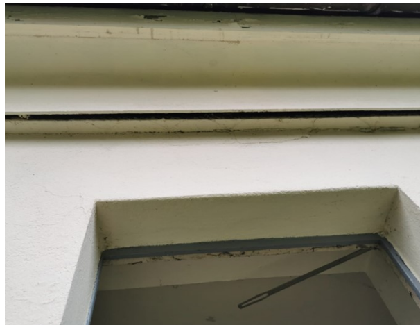
Abbildung 18: Spalt an Fassade
