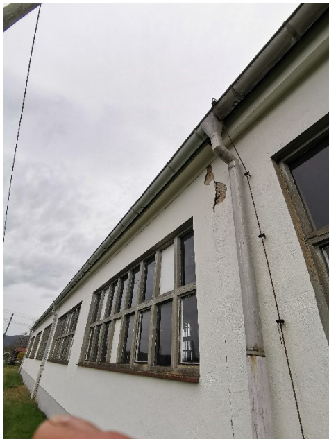
Abbildung 27: Werkstatt; Beschädigung an der Fassade und Spalt an Dachüberstand
