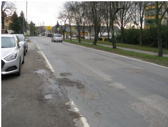
Foto: Straßenschäden Dresdner Straße
