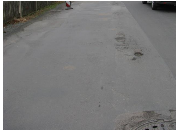
Foto: Straßenschäden Rudolf-Breitscheid-Straße
