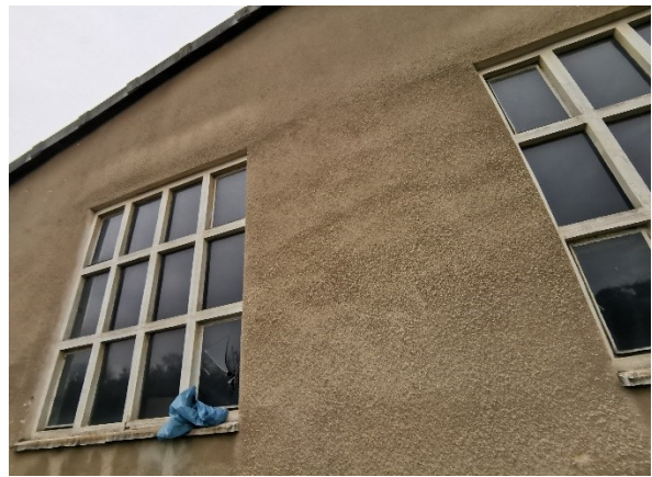
Abbildung 38: Lagerhalle; ausgeschäumtes Fenster
