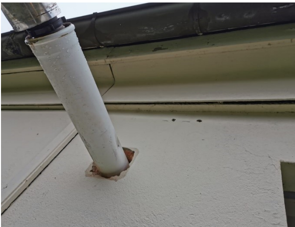
Abbildung 17: Spalt an Fassade
