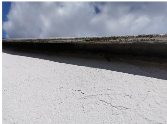
Abbildung 10: Blick vom Hubsteiger; Nahaufnahme Attika
