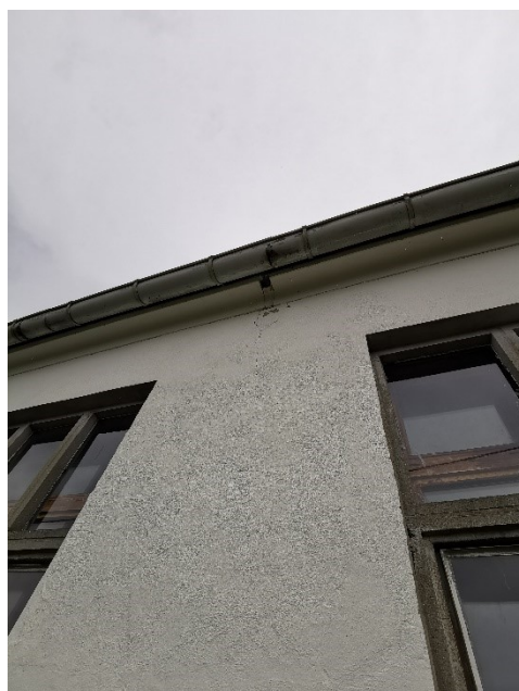
Abbildung 28: Werkstatt; Nahaufnahme des Spaltes am Dachüberstand
