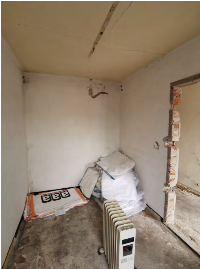
Abbildung 7: Innenbereich mit Wandrissen
