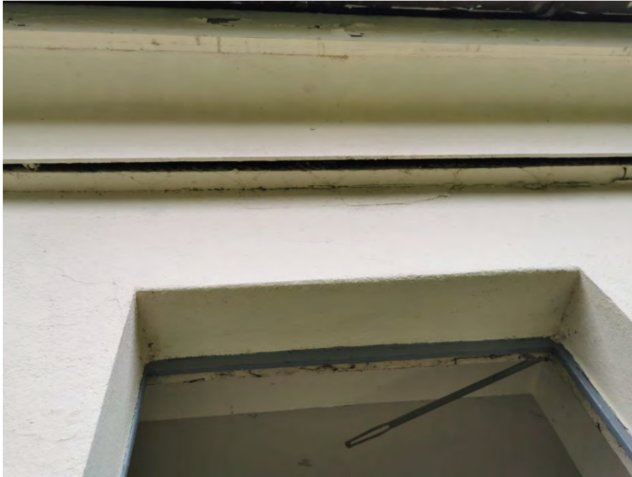
Abbildung 9: Spalt an Fassade
