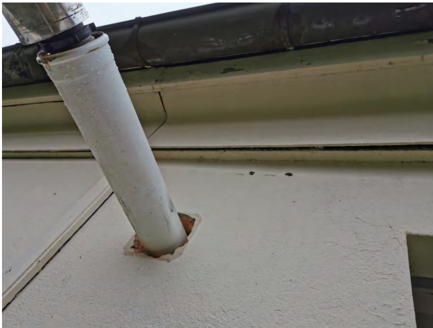
Abbildung 8: Spalt an Fassade
