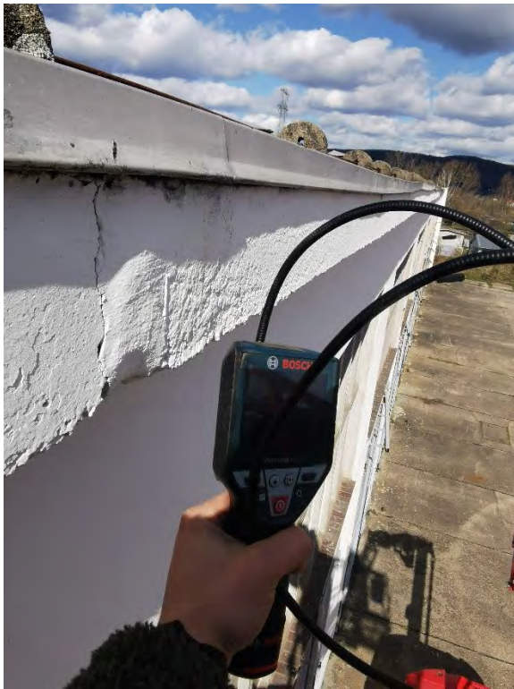
Abbildung 29: Endoskop zur Überprüfung der Attika
