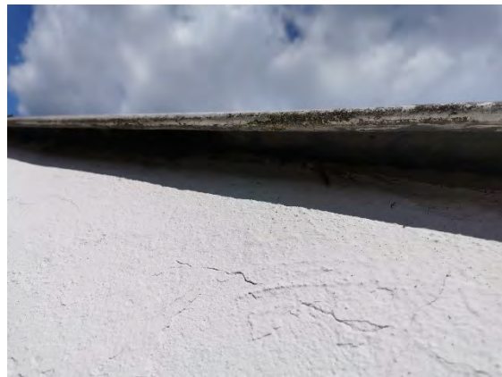
Abbildung 26: Blick vom Hubsteiger; Nahaufnahme Attika
