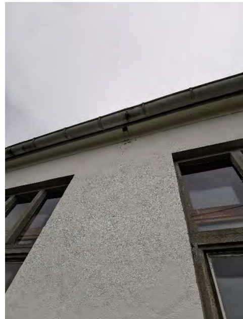
Abbildung 10: Werkstatt; Nahaufnahme des Spaltes am Dachüberstand
