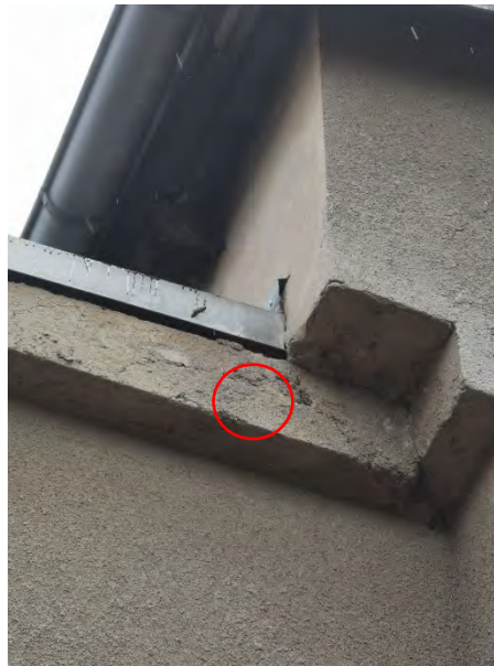
Abbildung 18: Lagerhalle; Biene, die in Spalt fliegt
