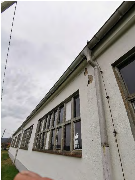
Abbildung 9: Werkstatt; Beschädigung an der Fassade und Spalt an Dachüberstand
